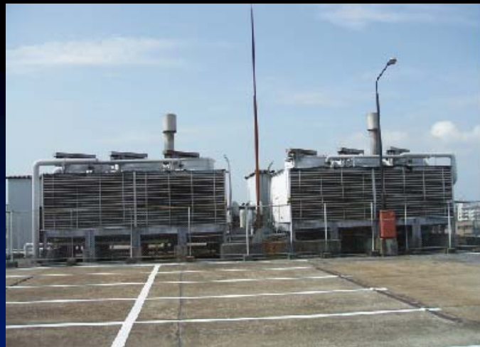
既存の屋上冷却塔 2機
