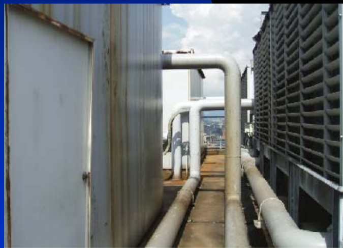
吸収式冷温水発生機(左)2機 冷却塔(右) 既存のタイプ
